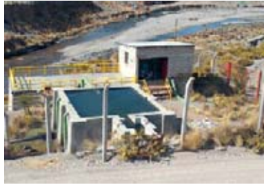
Planta de tratamiento de agua en Orcopampa, Arequipa.
